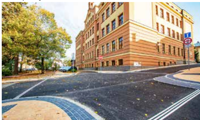
Výsadbou zeleně, nástřikem vodorovného dopravního značení a instalací svítidel veřejného osvětlení jsme dokončili rozsáhlou rekonstrukci Školní ulice
